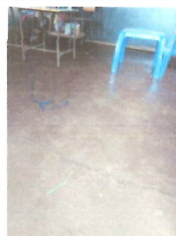
PISO, SUSTITUCION DE PISO TORTA ALISADA EN MAL ESTADO
